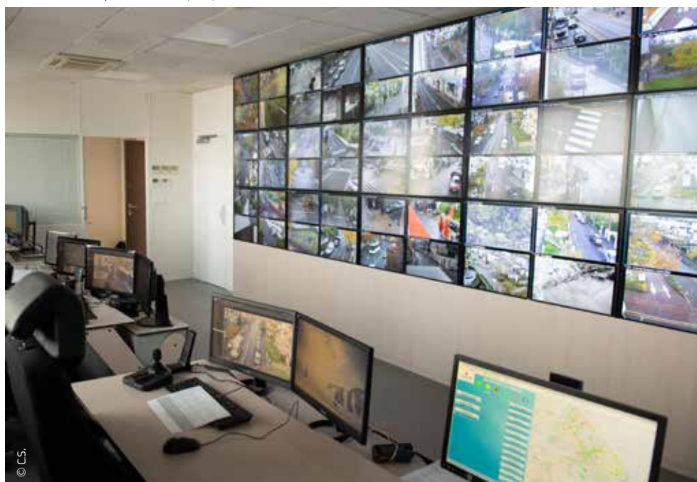
▼ Le centre de supervision vidéo (CSU)
